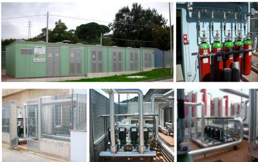
Figura 1: gli impianti tecnologici del datacenter SCoPE
